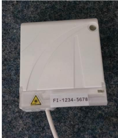
Figure 4 : repérage sur la prise mono fibre
