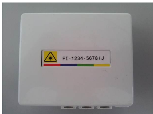
Figure 5 : repérage sur la prise quadri fibre
